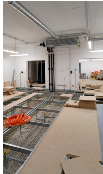
Installation dans le local technique
